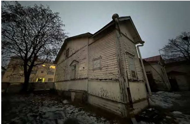
Kuva 78. Rakennuksen päädyn julkisivun vaurioita.
