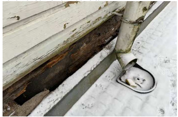
Kuva 81. Julkisivun alareunasta poislahonneita puuosia.
