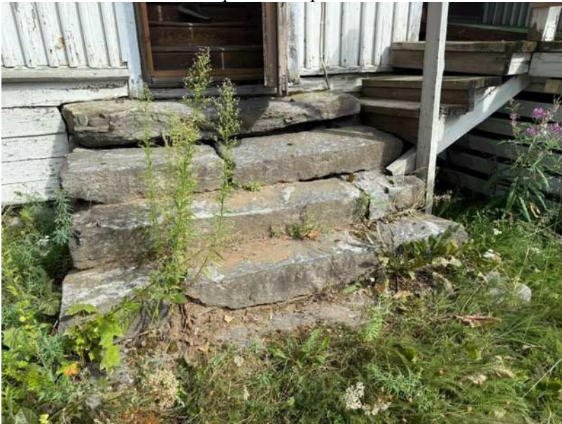
Kuva 2. Talon perustukset ovat painuneet.
