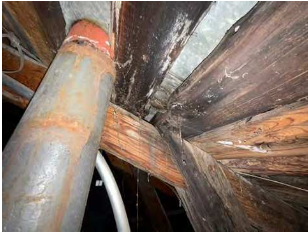
Kuva 86. Vesikaton paikallinen vuotokohta.
