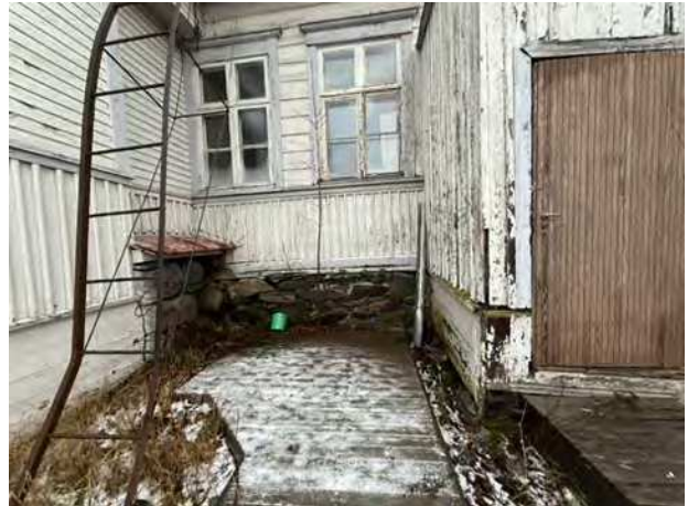
Kuva 35. Sisäpihan julkisivua, runsaasti kosteuden aiheuttamia vaurioita.
