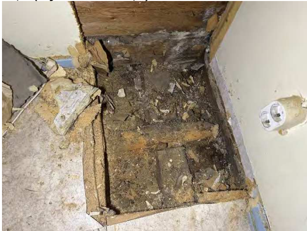
Kuva 74. Alapohjan lahovaurioituneita rakenteita.
