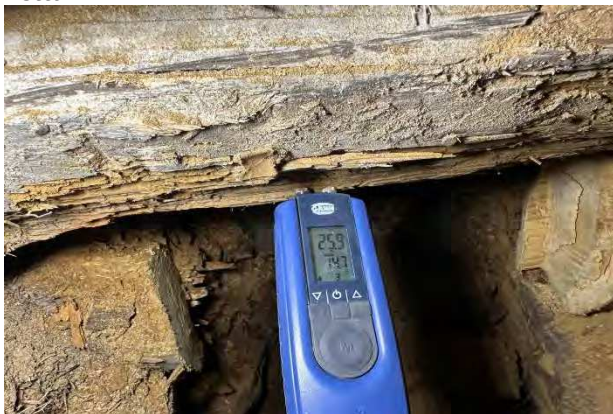
Kuva 62. Ulkoseinän alareuna on märkä, painprosentit 25,9 (raja-arvo on 18,9).
