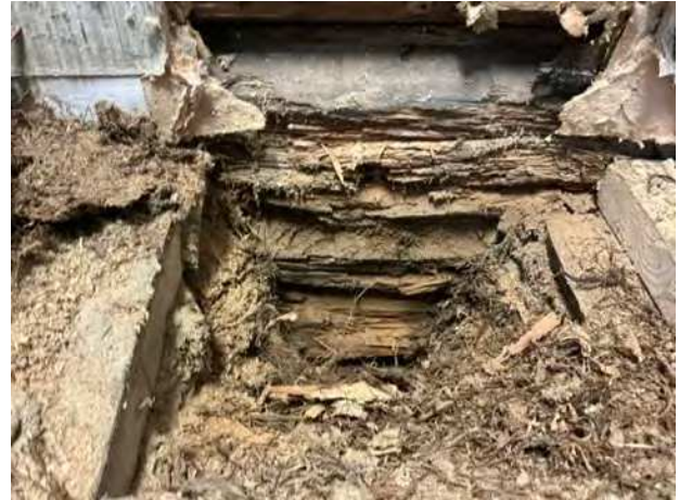
Kuva 25. Ulkoseinän alaosan lahovauriota.
