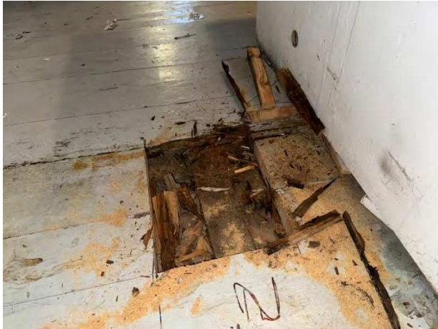
Kuva 30. Alapohjan lahovaurioituneita rakenteita.
