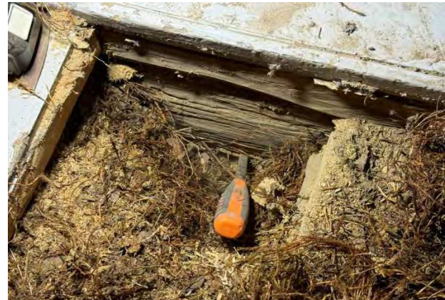
Kuva 23. Lahovauriota ulkoseinän alaosassa.
