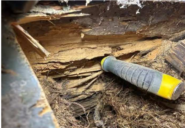
Kuva 18. Ulkoseinän alareunassa monin paikoin lahovaurioituneita hirssiä.
