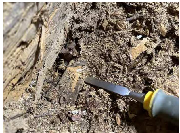
Kuva 77. Alapohjan lahovaurioituneita rakenteita.
