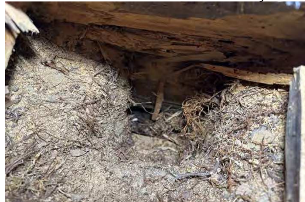
Kuva 21. Lahovauriota ulkoseinän alareunan hirsissä.
