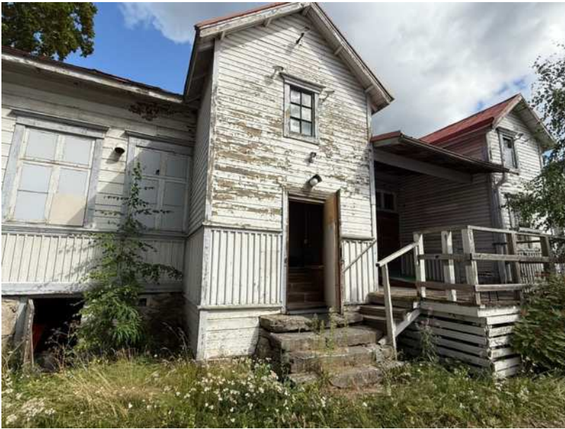
Kuva 1. Ulkoverhous on pahoin rapistunut.
