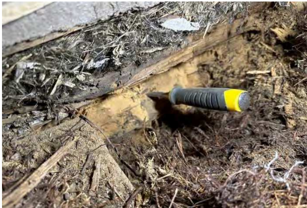
Kuva 20. Lahovaurioituneita ulkoseinän alaosan hirssiä.
