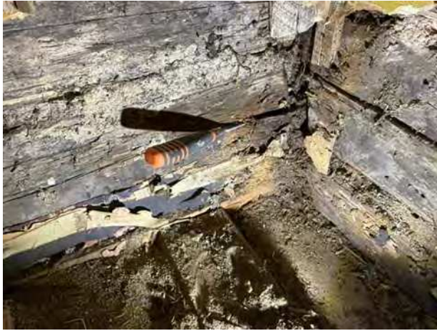
Kuva 66. Ulkoseinän alaosan lahovauriota.
