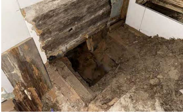
Kuva 60. Ulkoseinän alaosan läpilahonnuttua rakennetta.
