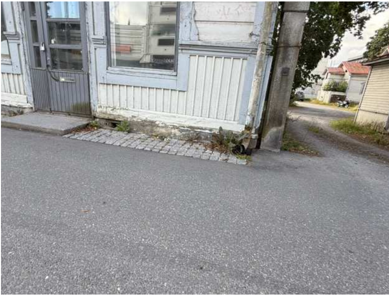
Kuva 3. Talo on uponnut katuun.
