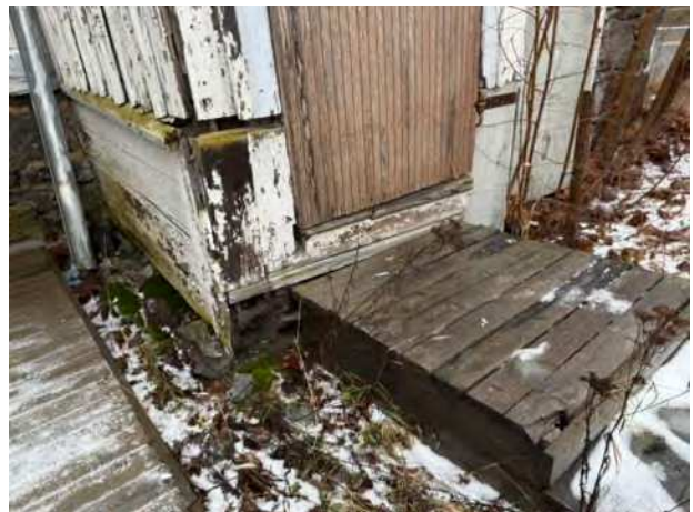
Kuva 37. Sisäpihan julkisivun vaurioita.
