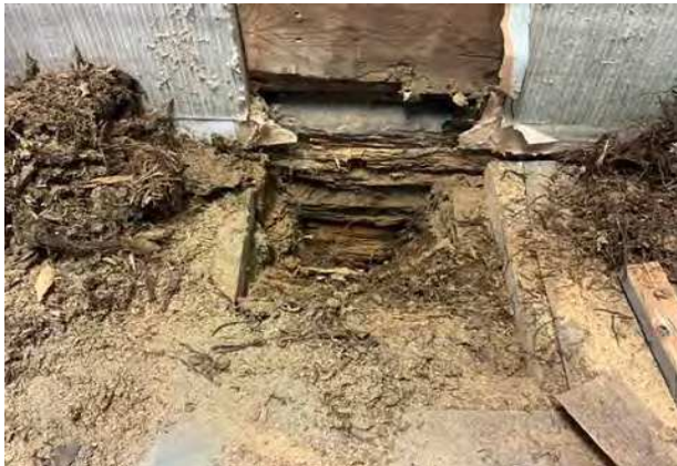
Kuva 22. Lahovauriota ulkoseinän alaosassa.
