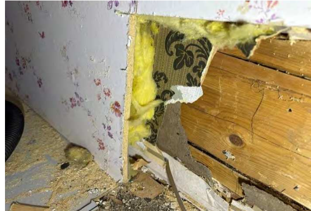
Kuva 19. Sisäpuolelta eristetyllä ulkoseinän osalla havaittiin kosteusvaurioindikaattorimikrobeja.
