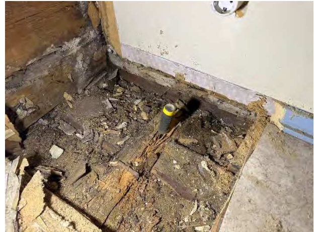
Kuva 75. Alapohjan lahovaurioituneita rakenteita.
