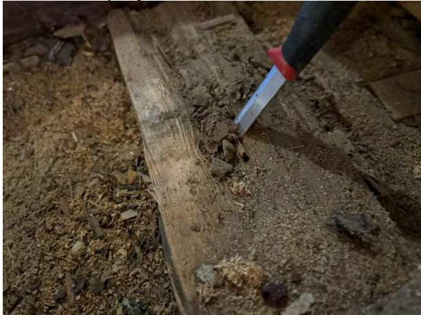
Kuva 32. Alapohjan lahovaurioituneita rakenteita.
