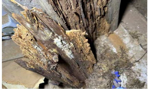
Kuva 61. Ulkoseinän alaosan lahovauriota.
