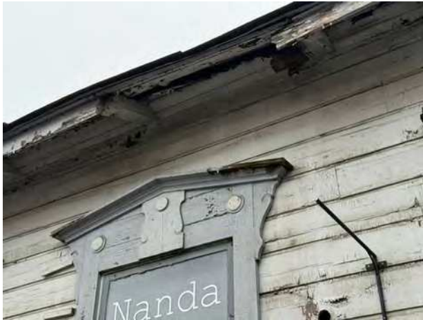
Kuva 44. Räystäissä lahovaurioita, osa räystäärakenteista sortunut.
