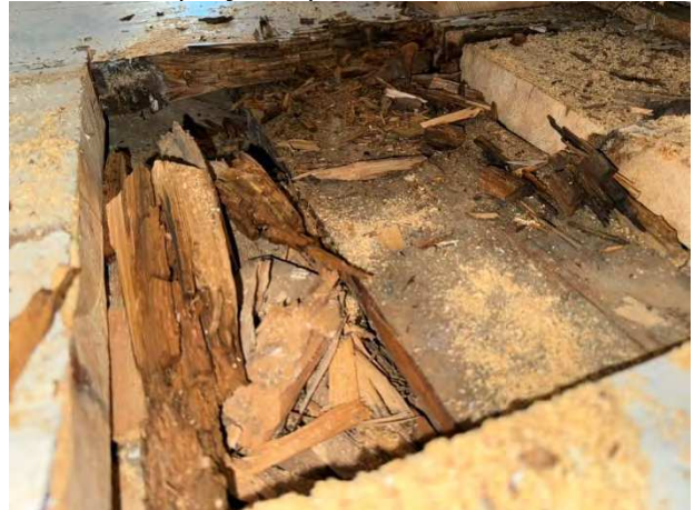
Kuva 33. Alapohjan lahovaurioituneita rakenteita.
